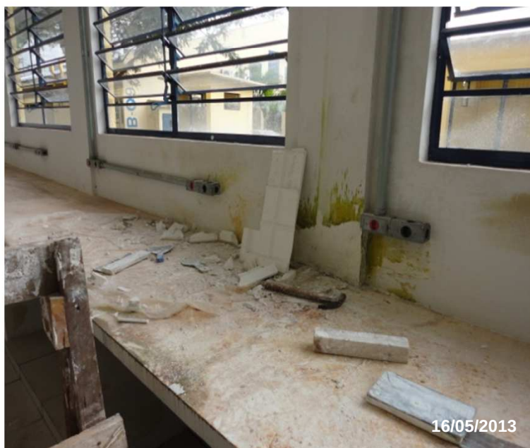
Sala 023 – Paredes com infiltrações
