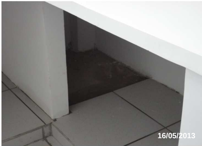
Sala 021 – Faltam pisos debaixo das bancadas.
