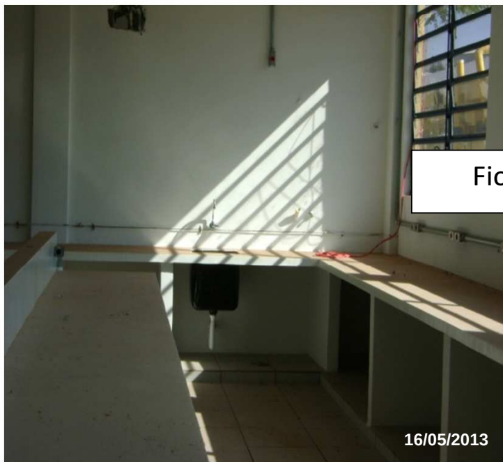
Sala 023 – Fios soltos nas bancadas.
