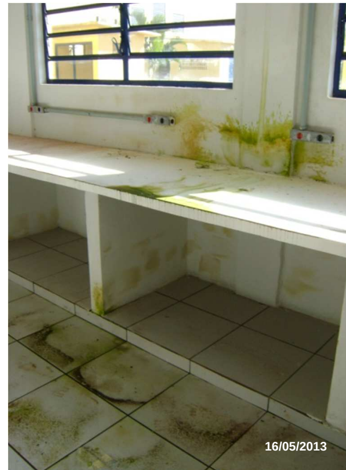
Sala 023 – Infiltrações e poças d'água.
