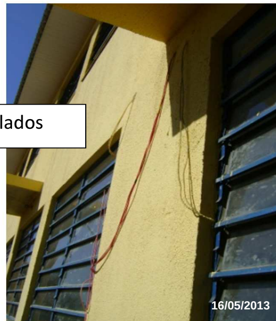
Sala 023 – Fios soltos na parte externa do prédio
