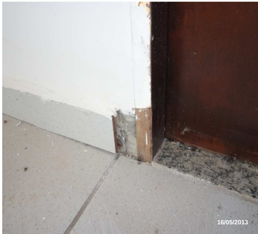
Sala 023 – Rodapés sem acabamento
