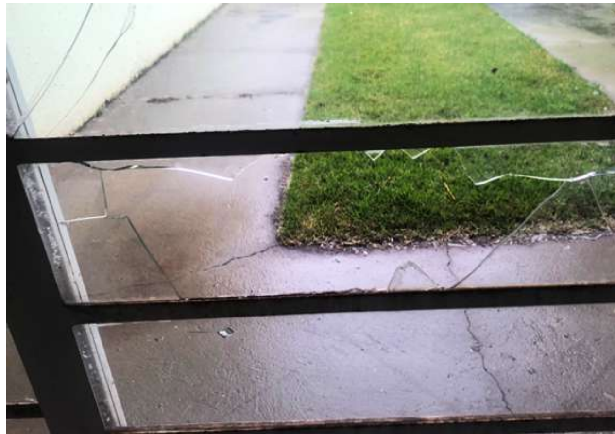
Vidros quebrados Escola Olga Aiub Ferreira
