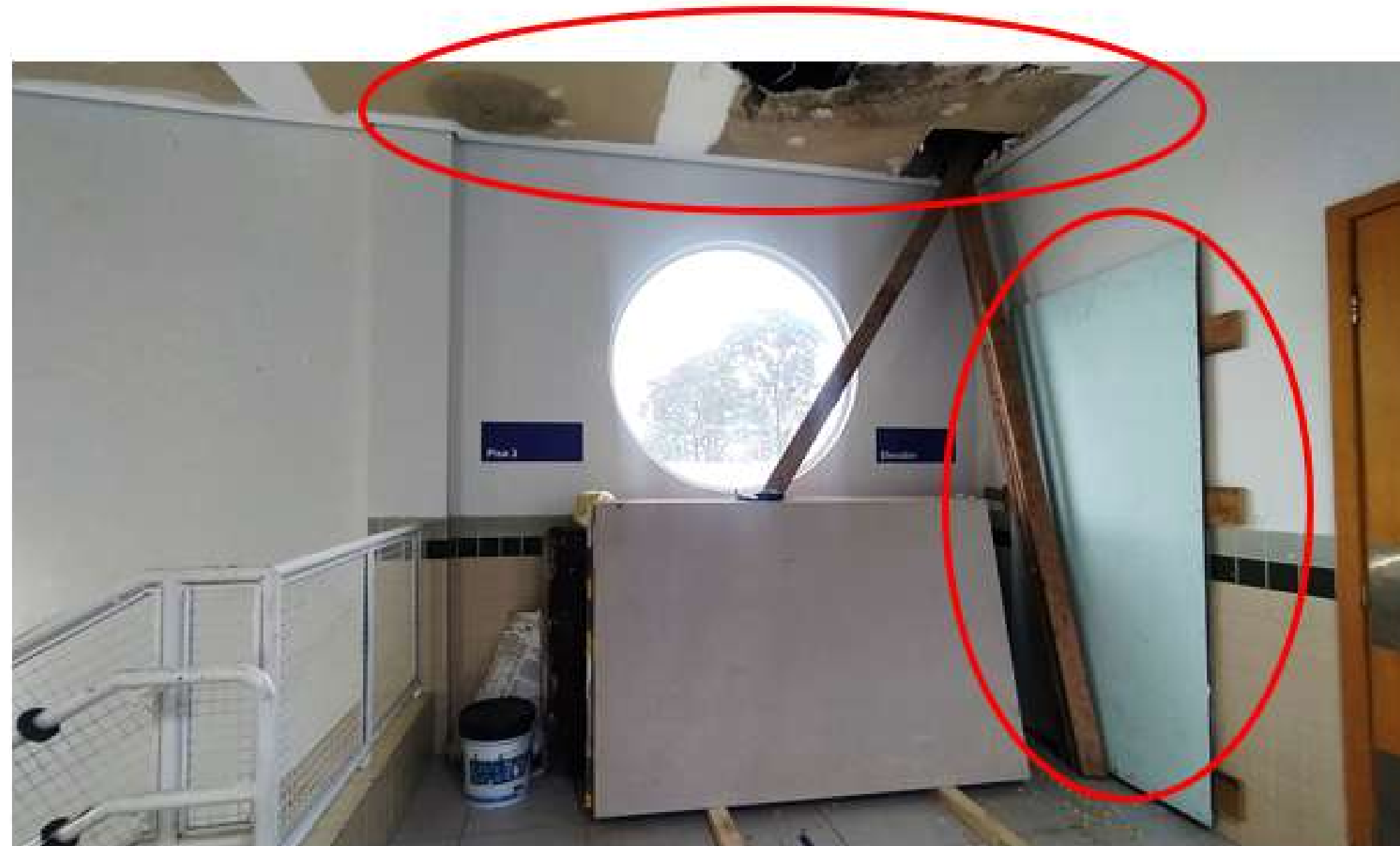
Infiltração próximo ao elevador quebrado
