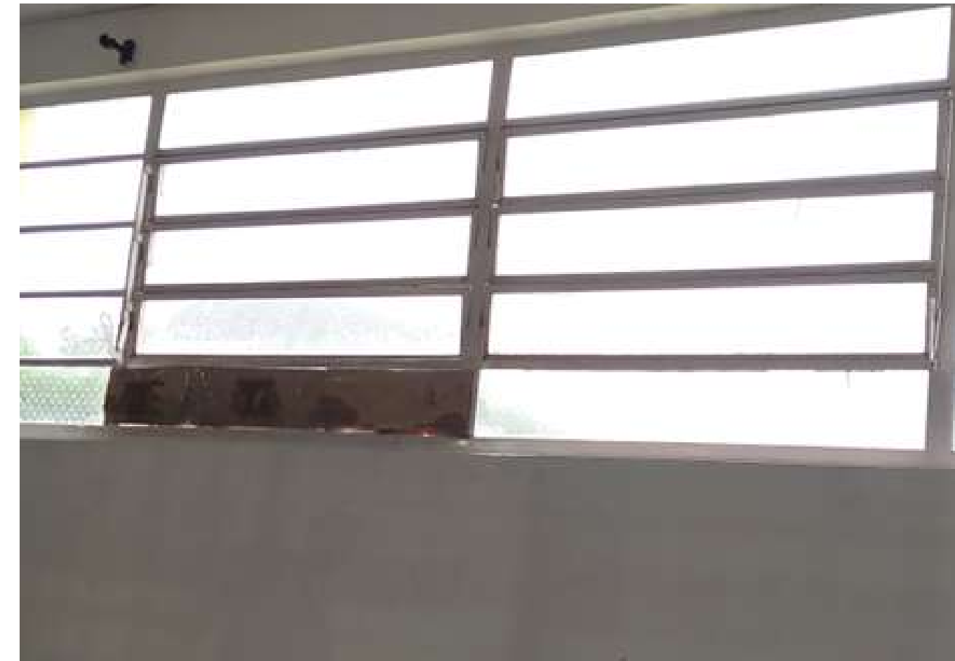
Vidros quebrados Escola Odette Alcântara Rosa
