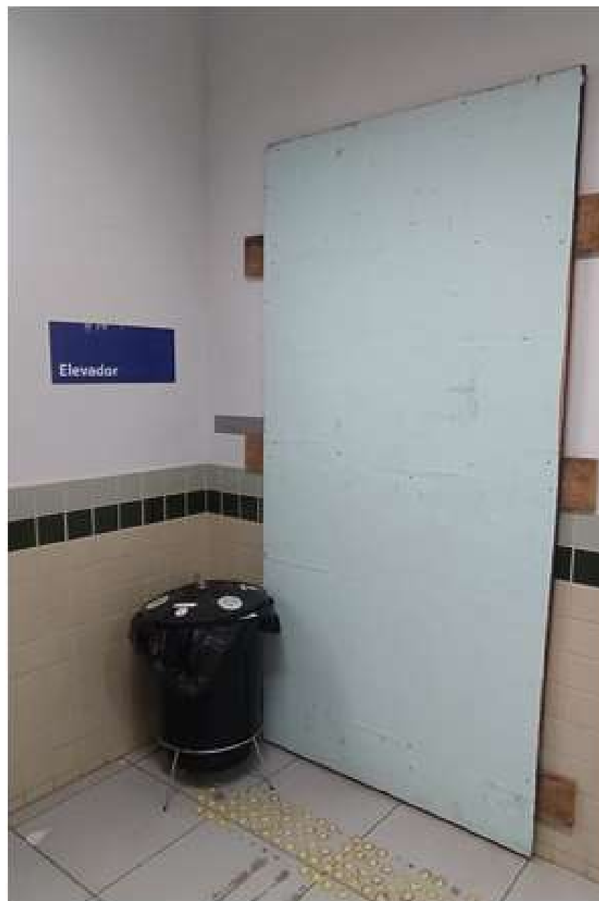
Elevador quebrado sem uso
